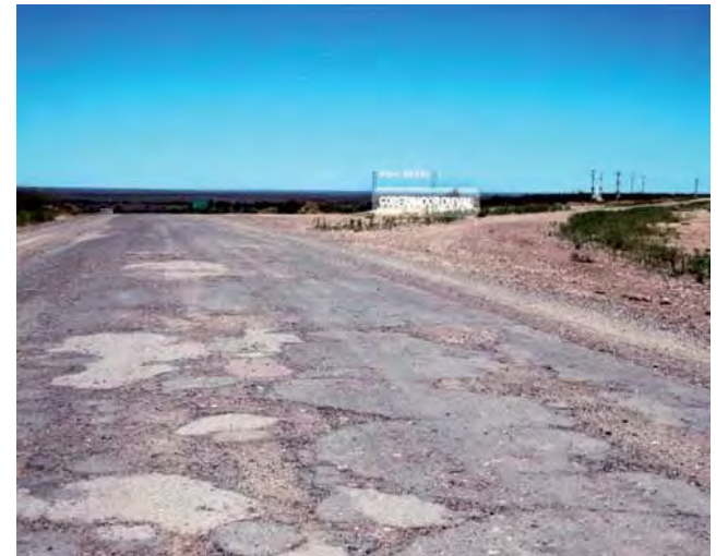
El tramo a reconstruirse de la RN 232 son 75 kms, que actualmente se encuentran muy deteriorados.
